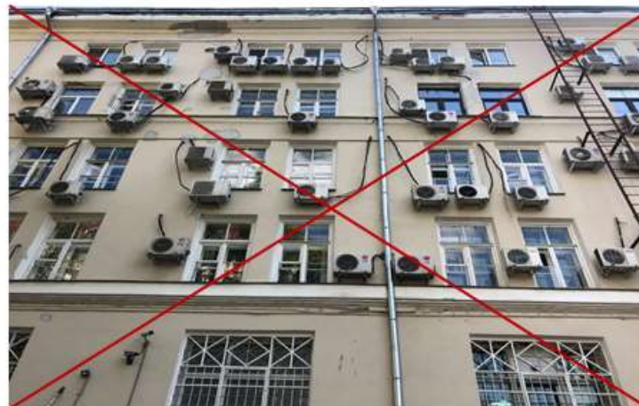
Пример НЕ правильного размещения кондиционеров на внутридвором фасаде
